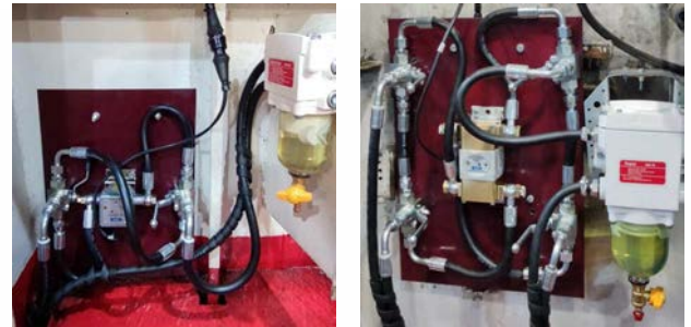
Medidores de flujo DFM 100 (a la izquierda) y DFM 500D (a la derecha), instalados en paneles separados
