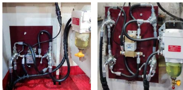
Расходомеры DFM 100 (слева) и DFM 500D (справа), установленные на отдельных панелях
