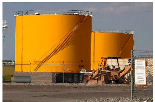
Le carburant contenu dans les réservoirs fixes est destiné à alimenter les machines spécialisées en fonctionnement sur le site
