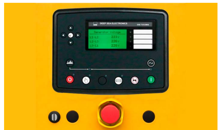
Controlador DSE 7320 MKII instalado en el generador
