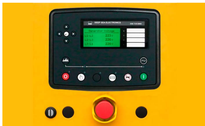
Contrôleur DSE 7320 MKII installé sur le groupe électrogène
