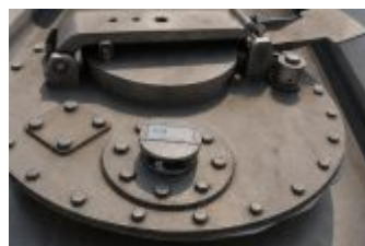
Sensor instalado en la cisterna
