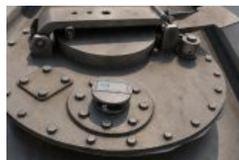
Capteur installé sur la citerne
